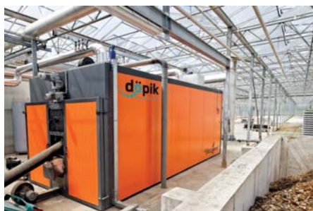
Chaudière plaquettes avec un silo de stockage.
